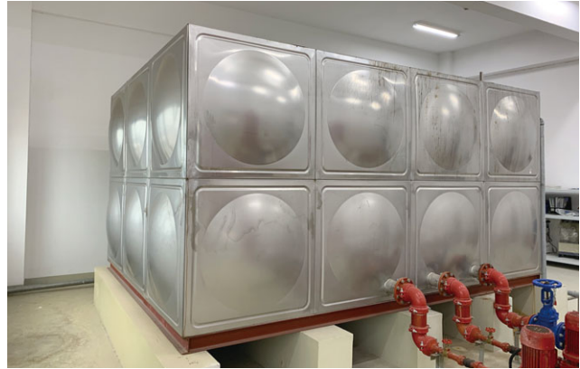
中水回用設備
