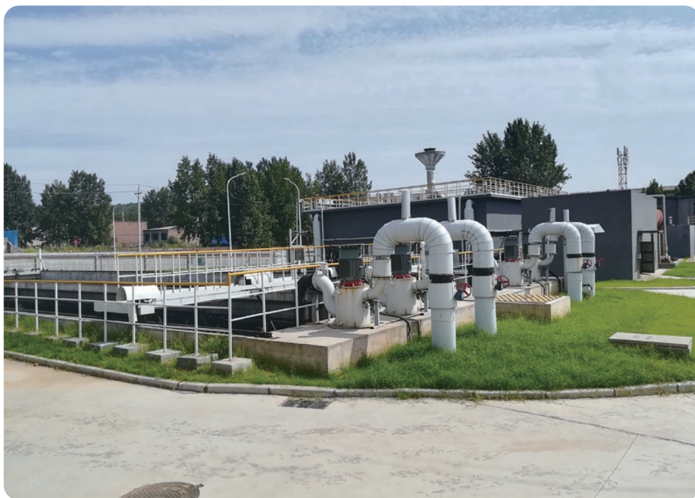
登封公司矿井水重复利用系统
