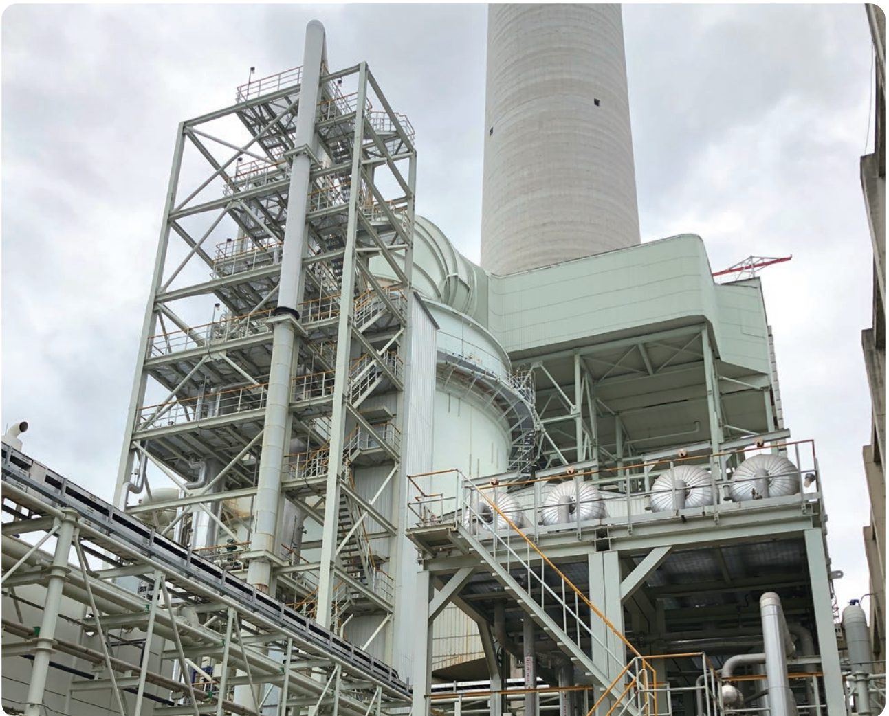
深圳公司碳捕集测试平台
