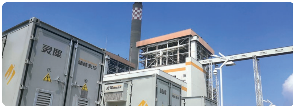
华润智慧能源常熟电厂 24MW 火储联合调频项目
