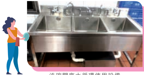
洗碗間廢水循環使用設備
