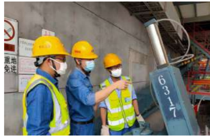
现场安全隐患排查
