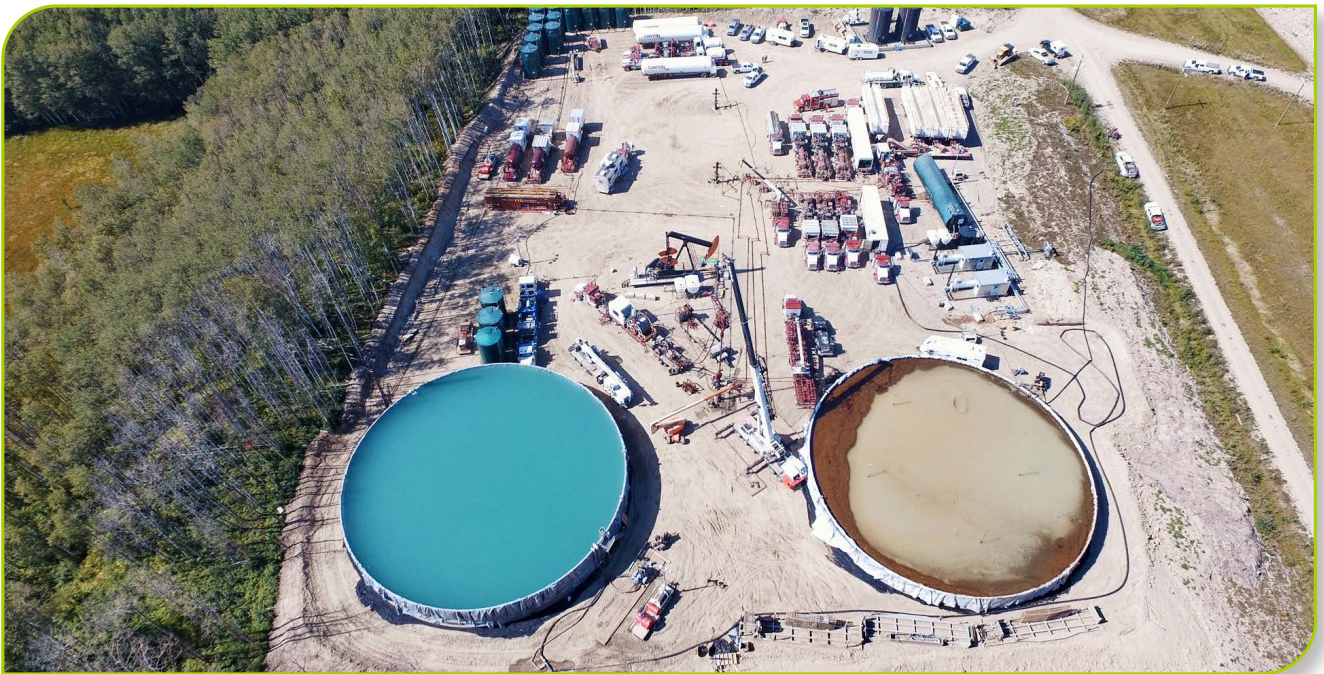
Recycling wastewater from hydraulic fracturing 對水力壓裂產生的廢水進行回收處理
