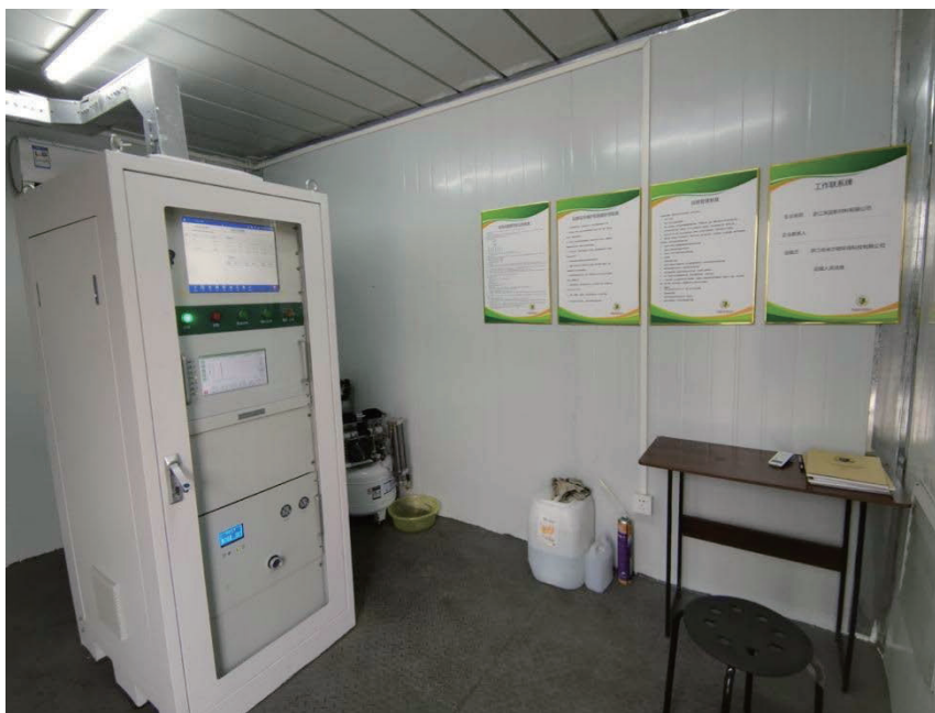
(廢氣排放數據在線監測設備)
