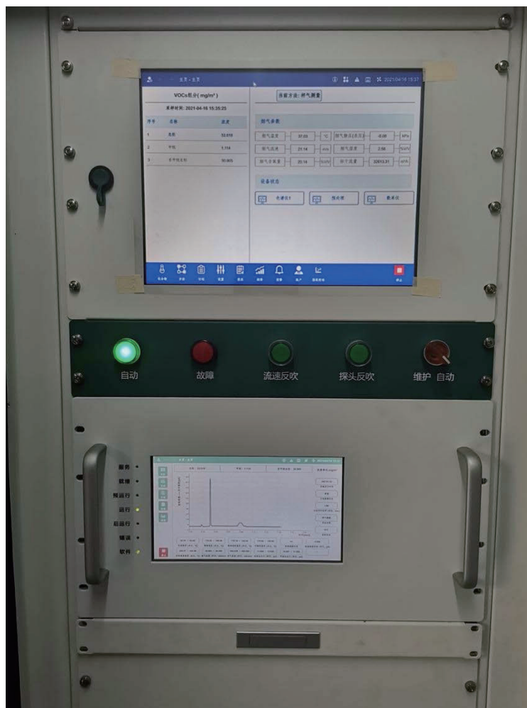
(廢氣排放數據在線監測設備)
