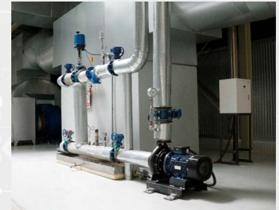
貴陽工廠安裝的餘熱回收系統
