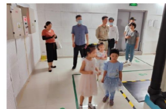
北京亞奧金茂悅舉辦“機房開放日”活動，幫助業主更好了解設備設施的運行及維護狀況
