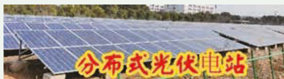
分散式光伏電站
