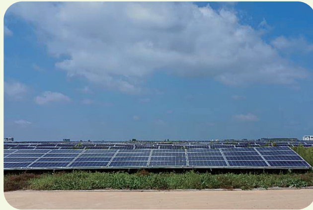
▲ 方山縣光伏電站項目
