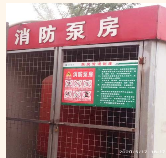
定型化消防泵房
