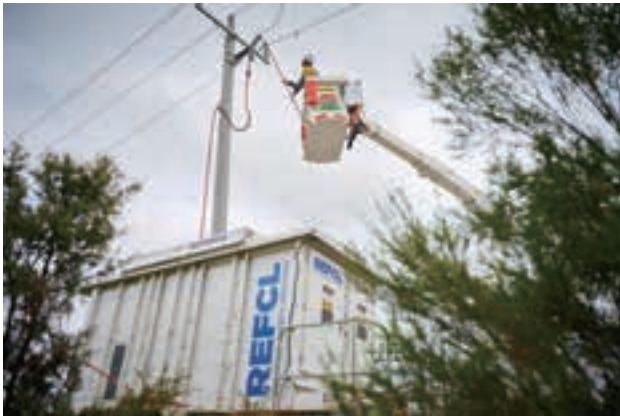
Powercor 安裝快速故障電流限制器
