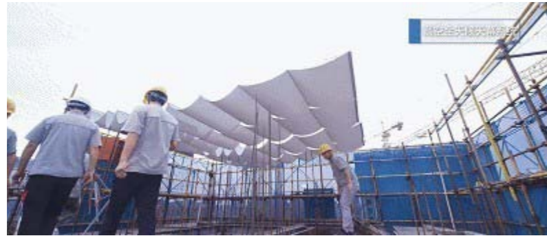
結構車間一 高空全天候天幕系統
