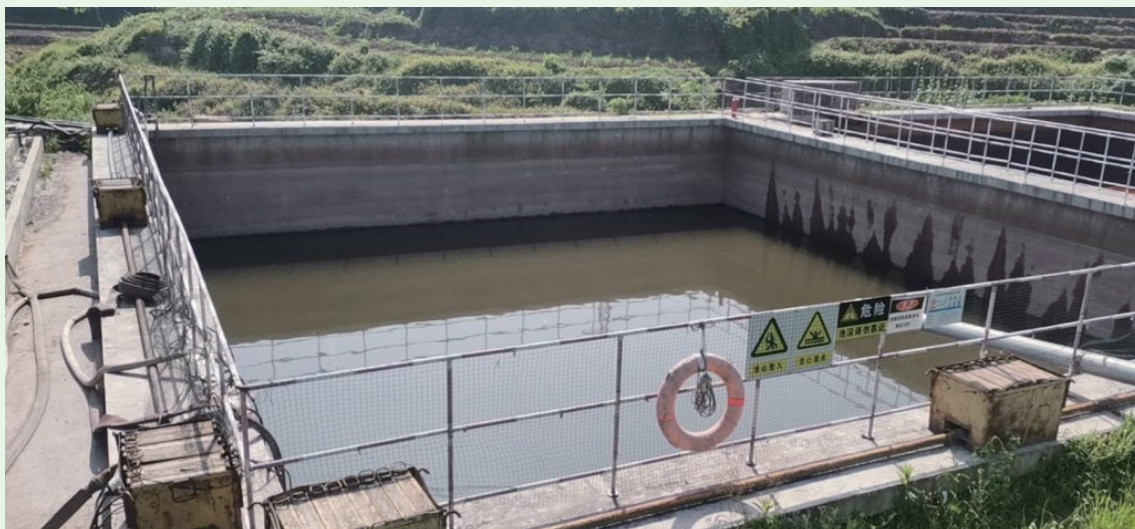
四川瀘縣陽101H53平台生活污水池
