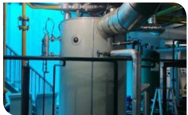
空港大酒店將鍋爐更換成能源效益更高的型號，節省了8%能源。
