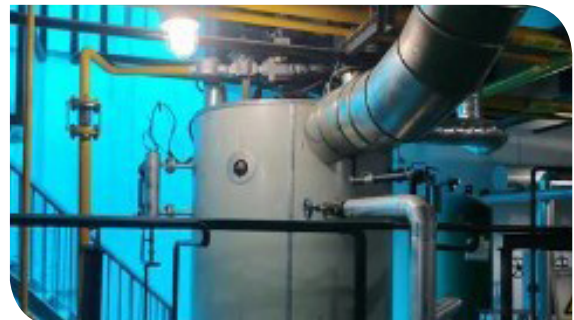
空港大酒店將鍋爐更換成能源效益更高的型號，節省了8%能源。
