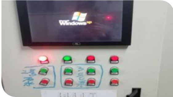
富豪金豐酒店在中央空調系統安裝了螺旋式水泵變頻系統，可節省50%或以上的電力消耗。
