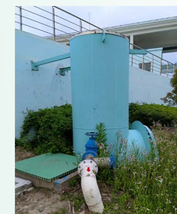
華東分部污水處理項目中水取水罐
