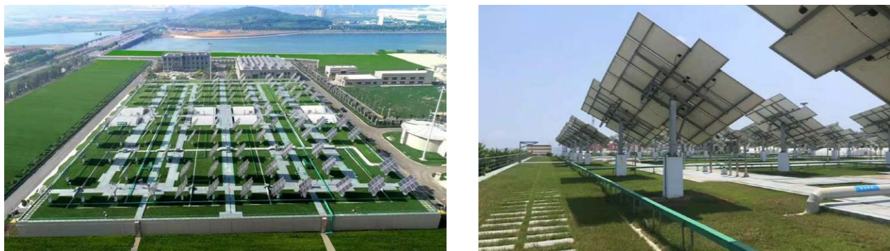
大連泉水河污水處理廠（二期）項目安裝的太陽能電池板
