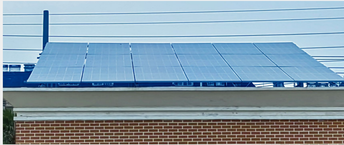
蕪湖先聲配電房頂部的太陽能板
