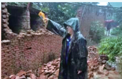
鶴壁天倫對坍塌位置進行漏氣 排查
