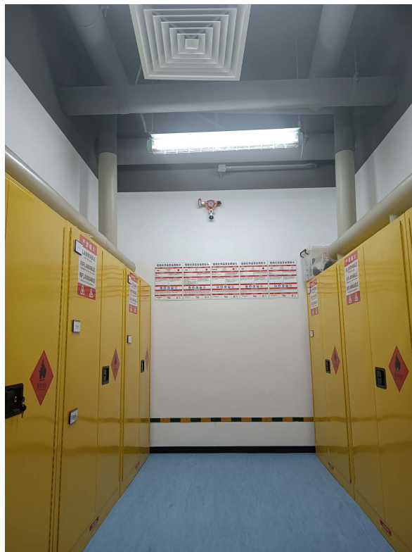
化學品管理(安全儲存櫃、防爆、通風、防洩漏)
