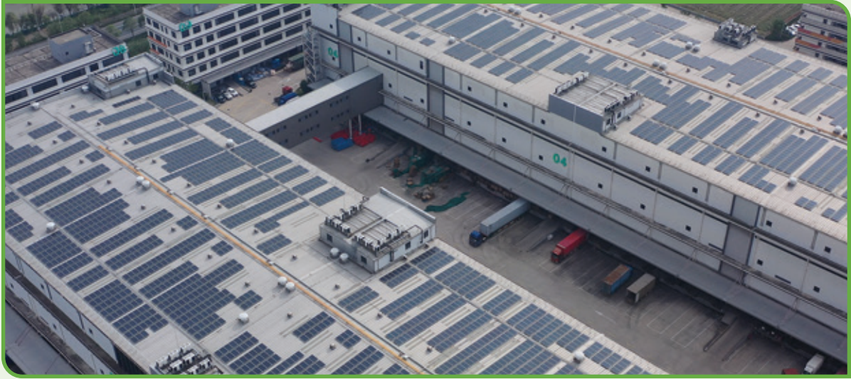
圖：菜鳥物流園區光伏發電項目
