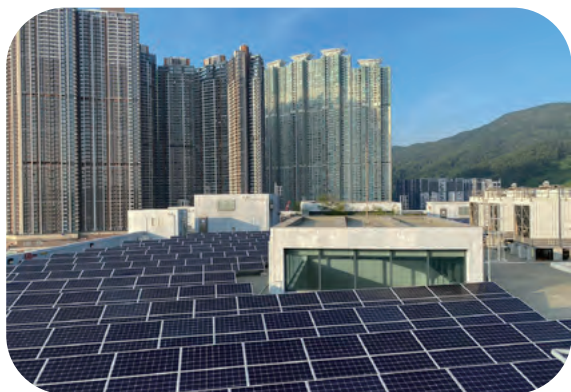
太陽能發電項目
