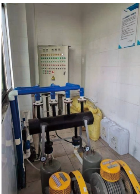
海南食品廠 - 污水處理設施
