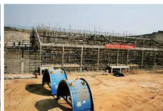
中區—磨礦車間—33KV配電室
