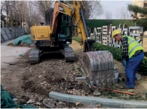
寶豐縣銀龍水務有限公司管網施工結束後對路邊植被進行恢復
