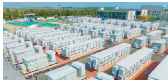
海陽儲能電站
