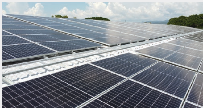
在泰國安裝的太陽能發電板。
