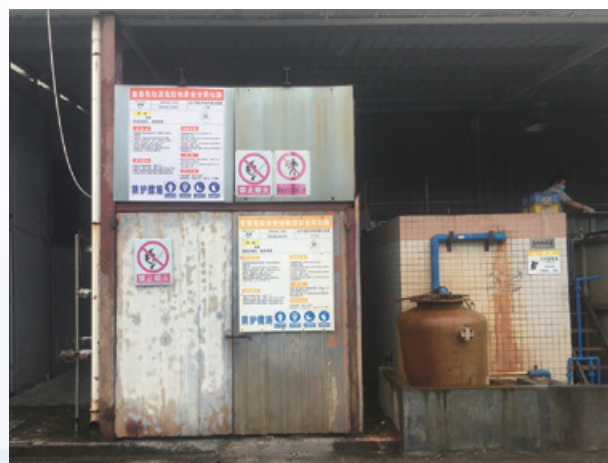
Sewage treatment system 污水處理系統
