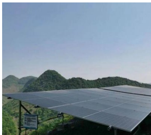
長沙院光伏灌溉項目建成落地
