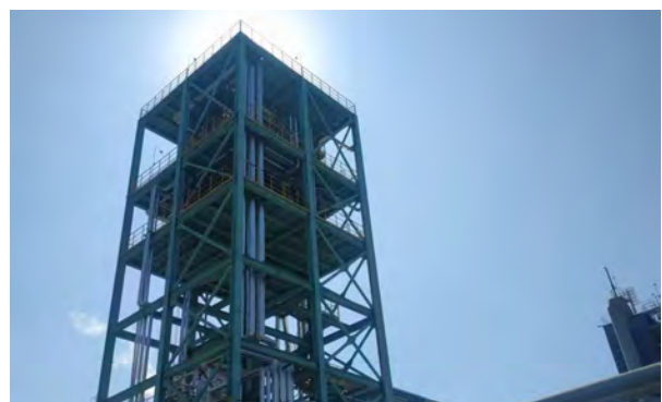
焦化上升管余热回收项目
