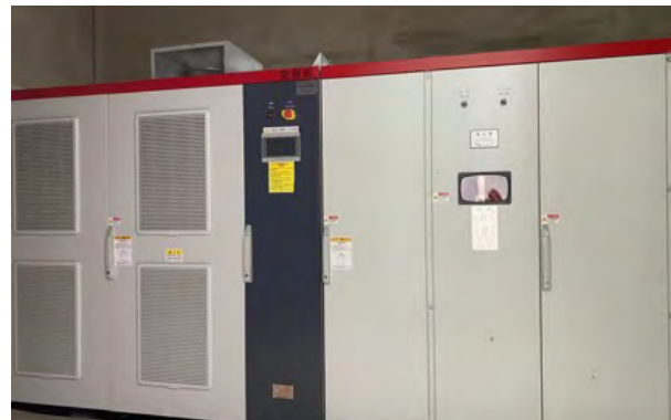
循环水油环泵高压变频器
