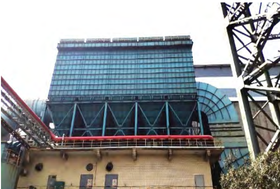
高炉矿槽袋式除尘器
