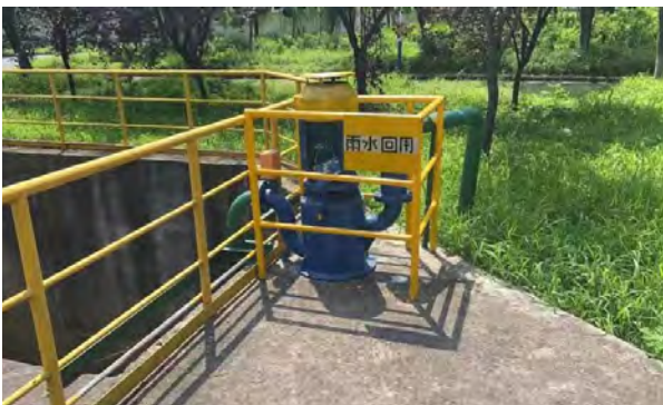
雨水回用收集池
