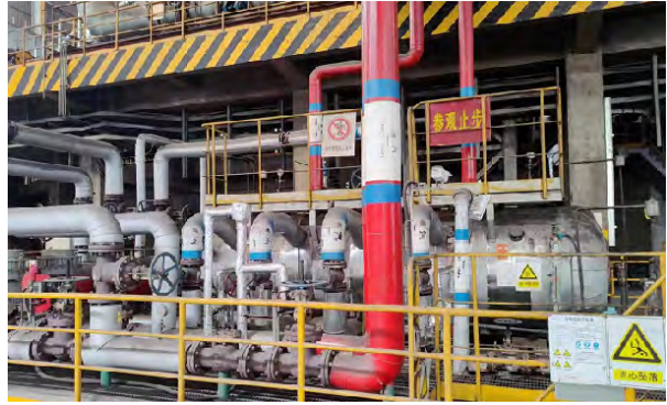
靖江特钢余热蒸汽外供管道
