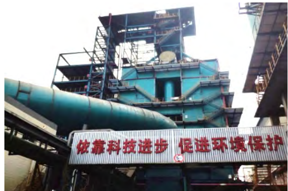
400m 2 烧结机头活性焦脱硫脱硝一体化
