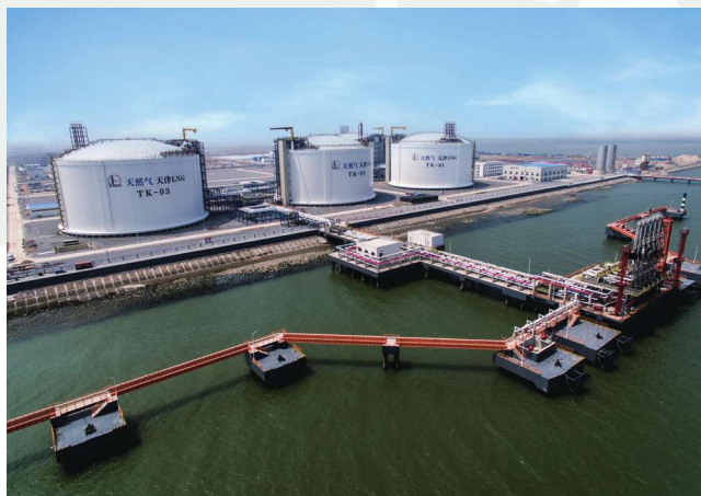
天津 LNG 項目
