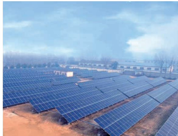
兆瓦级电解水制氢配套光伏项目
