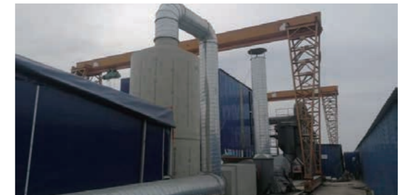
第十建设公司盛虹炼化工程项目部 VOCs 处理设施
