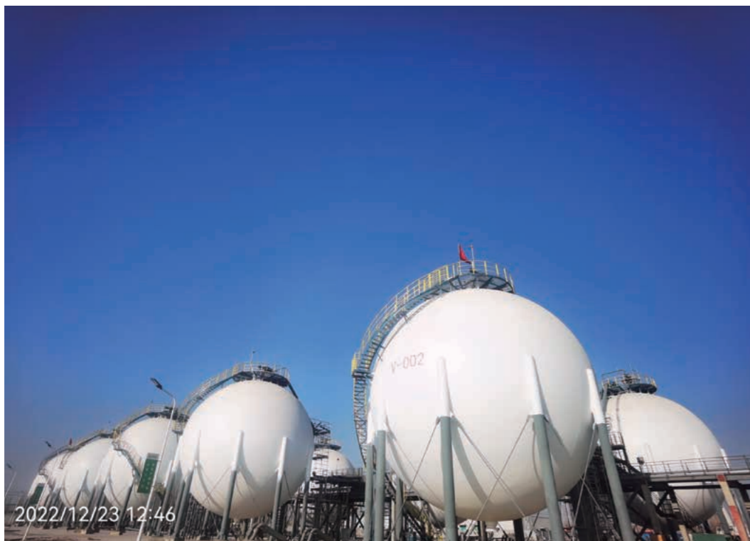
绿氢项目氢气球罐
