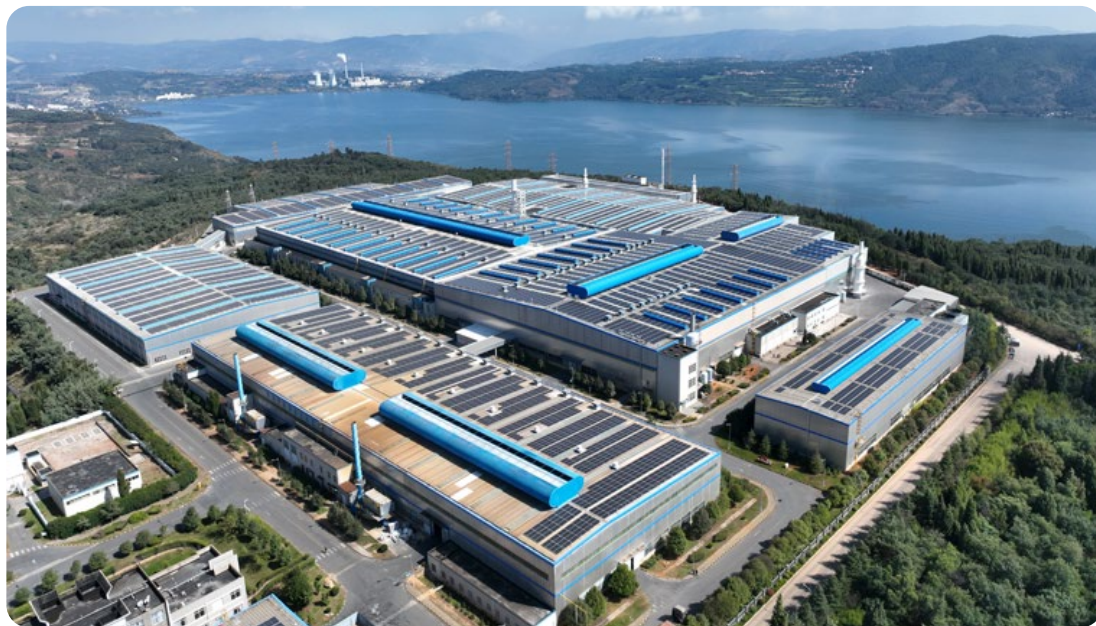
雲鋁股份屋面光伏發電設施
