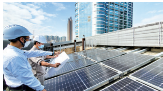
兩個物業於2022年度安裝更多太陽能光伏板，以充分利用陽光產生可再生能源。
