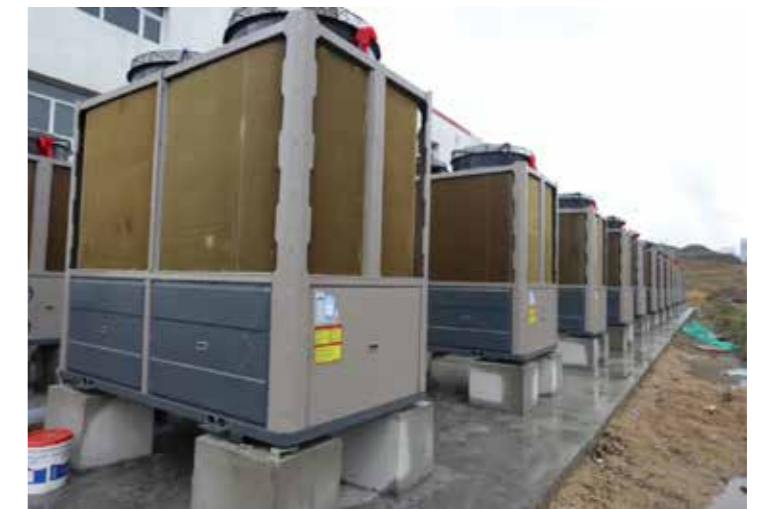
內蒙古太平空氣源熱泵供暖系統
