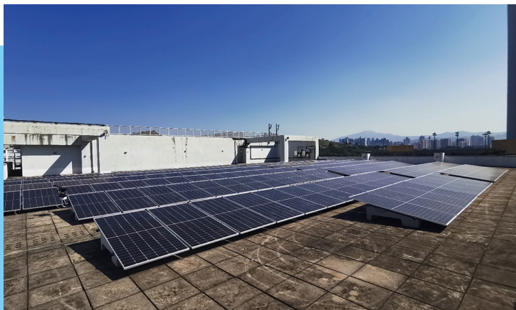
天水圍電話機樓的太陽能發電系統
