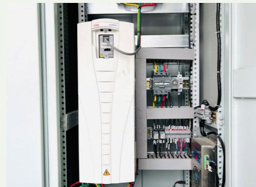
提升泵房潛水泵配備變頻器以達到節能需求
