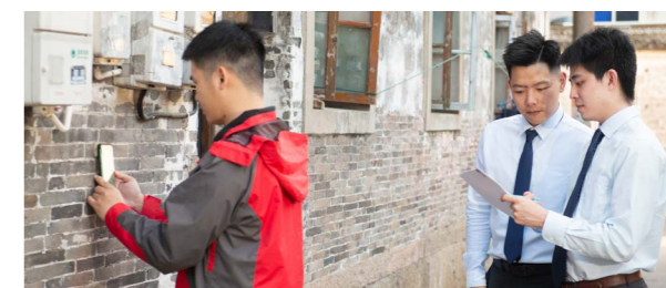
寧波市分公司工作人員通過測量、記錄外牆的裂縫、空鼓等情況，避免出現因外牆空鼓而導致的脫落事件，保障居民財產和生命安全
