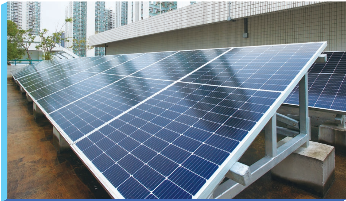
置富第一城安裝的太陽能板
