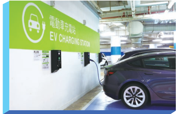
電動車充電設施
