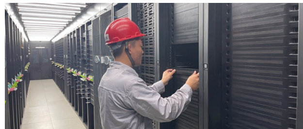
◎ 補齊盲板避免冷量損失
