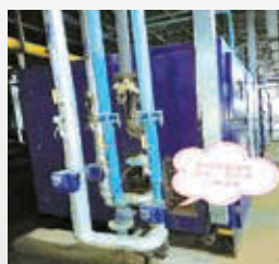
空壓機餘熱回收機組
