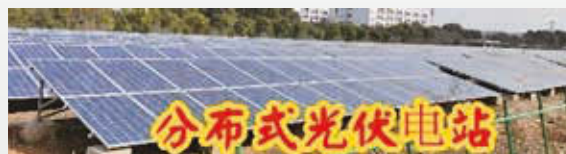
分散式光伏電站
