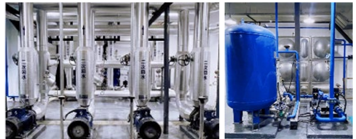
電鍋爐水蓄熱供熱項目實圖
