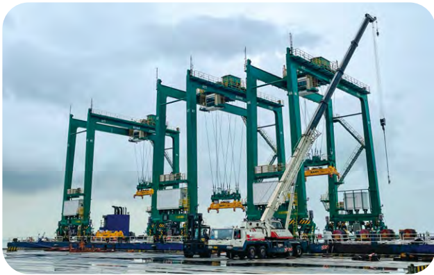
廣州南沙海港碼頭和 廣州南沙港務碼頭對柴油機進行鋰電池改造。
