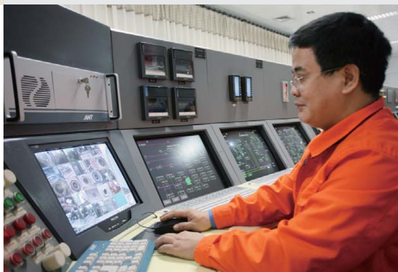
主控室操作人員正在進行日常巡檢
