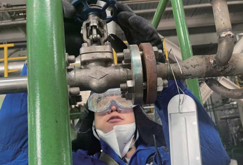
調節氨泵水箱補液閥門
