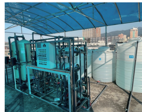
清洗廢水循環利用裝置
