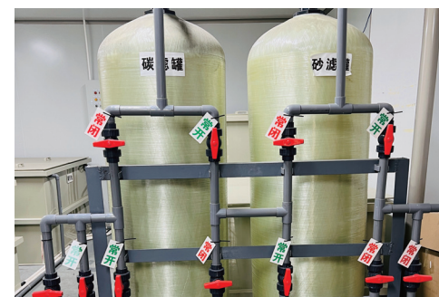
廢水回收利用設施
