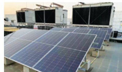
亞信科技大廈頂樓光伏設施
