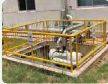
圖：洞庭藥業工業凝水回收改造
