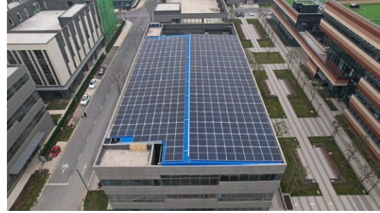
蔡甸數字產業園分佈式光伏發電
