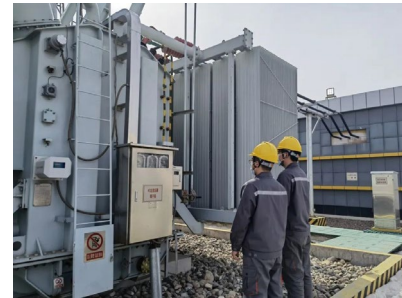
新能源公司巡視檢查設備
